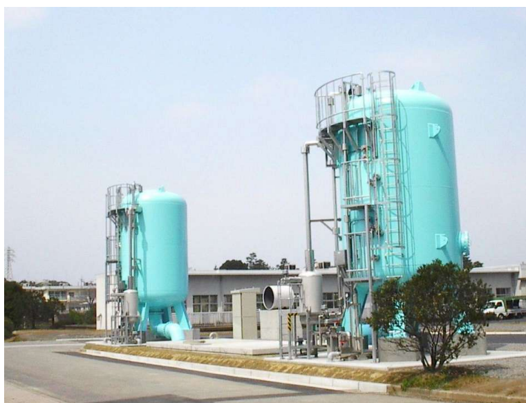
2基の全景写真
