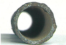
12年間使用した冷温水配管 (地下埋設の断面部分)
